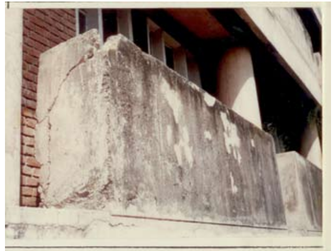
Сл. 14 Оштећење бетона
